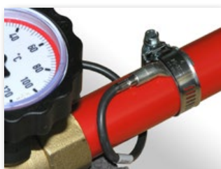
Figure 2: Connexion de la sonde de température sur le tuyau d'alimentation
